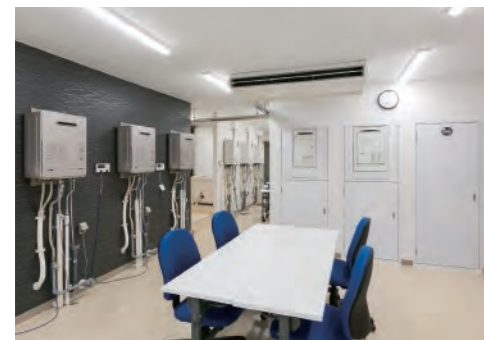
実際にお湯はりから、パイプシャフトでの機器取替まで 幅広く学べる温水機器施工ブース
